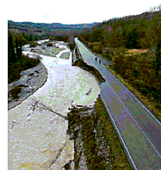
FRANE La strada dopo le piogge
